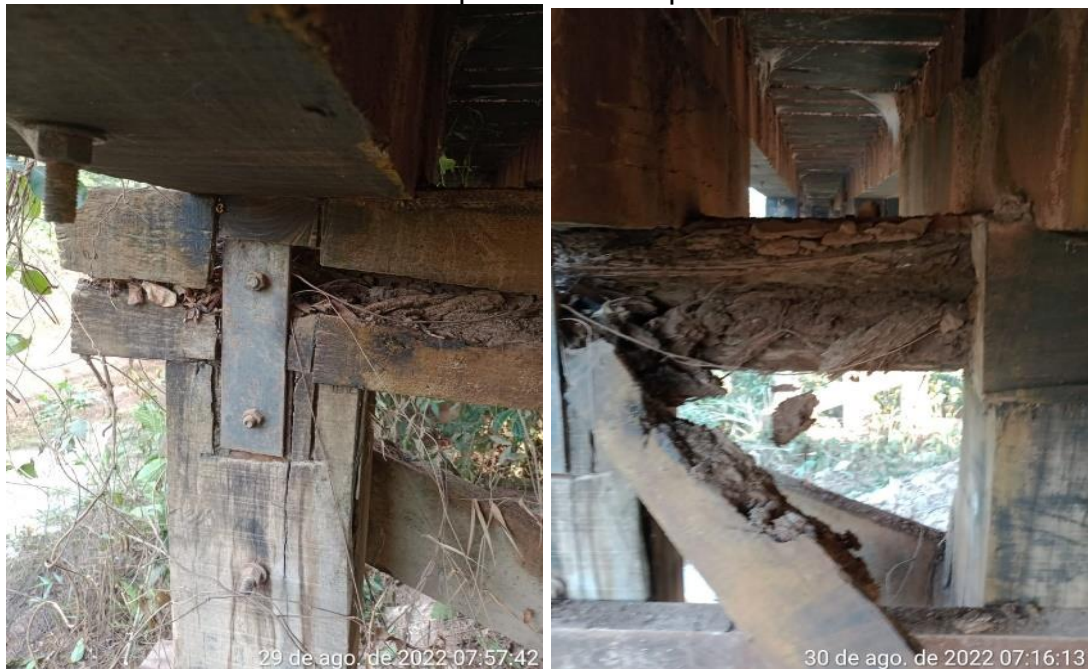
Ponte sobre o Rio Branco em péssimo estado, apresentado dezenas de patologias que causa perigo para os condutores da MT-313.
