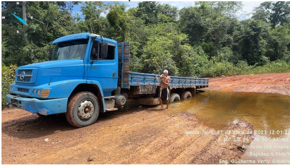
Levantamento de aterros com material de 1º categoria para que as águas fluviais não passe sobre a plataforma.
