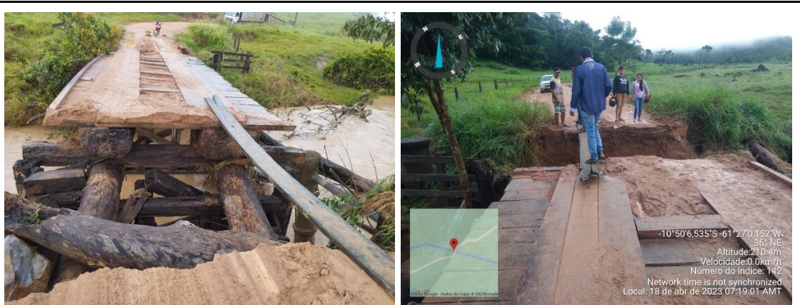
Pontes em péssimo estado pois a madeira se deteriora com o tempo e as condições do clima.
